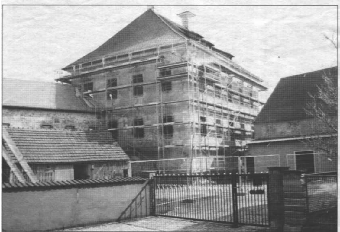
Der gesamte Sanierungskomplex „Hammerschloss“: der Meierstadt (rechts), der ebenfalls saniert wird, in der Mitte das eingerüstete Hammerherrenschloss, links ein Nebengebäude, das ehemalige Krausanwesen, das auch in die Sanierung mit einbezogen ist. Bilder: pop
